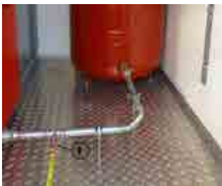
Bild: Befüllen des Heizmobils
