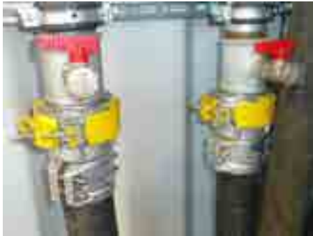
Bild: Anbindeleitungen mit gelben Sicherungsschellen
