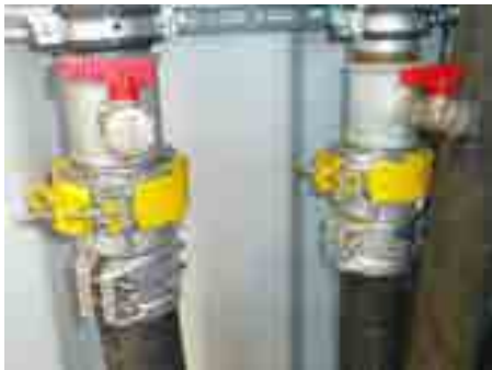
Bild: Anbindeleitungen mit gelben Sicherungsschellen
