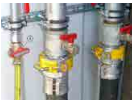
Bild: Entlüften des Heizcontainers
