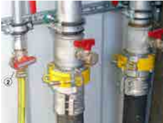
Bild: Kugelhahn der Entlüftungsleitung öffnen
