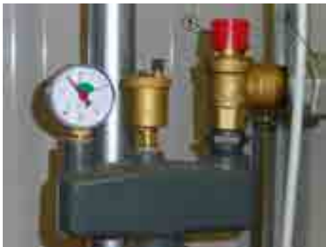
Bild: Innenansicht, Sicherheitsventil
