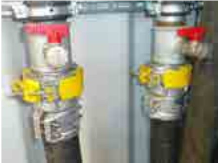
Bild: Anbindeleitungen mit gelben Sicherungsschellen
