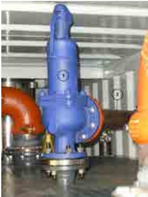
Bild: Innenansicht, Sicherheitsventil
