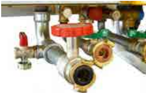
Bild: Kugelhahn der Entlüftungsleitung öffnen
