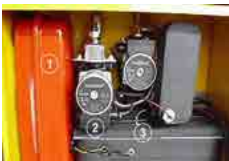
Bild: Innenansicht, MAG, Sicherheitstemperaturbegrenzer, Luftfühler
