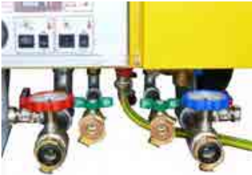
Bild: Entleer-Kugelhahn öffnen und Wasser ablassen
